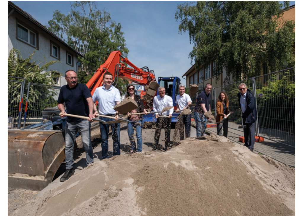
Mit dem ersten Spatenstich wurde im Mai der Startschuss für Nahwärme in der Innenstadt gegeben. Durch die Netzerweiterung wurde die Voraussetzung für umweltschonendes Heizen und damit auch für die energetische Sanierung älterer Bestandsbauten im Stadtzentrum Rastatt geschaffen.
