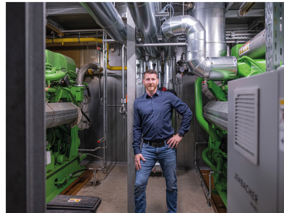
Daniel Steinke, Meister im Bereich Energieanlagen, in der Heizzentrale am Joffre Areal.
